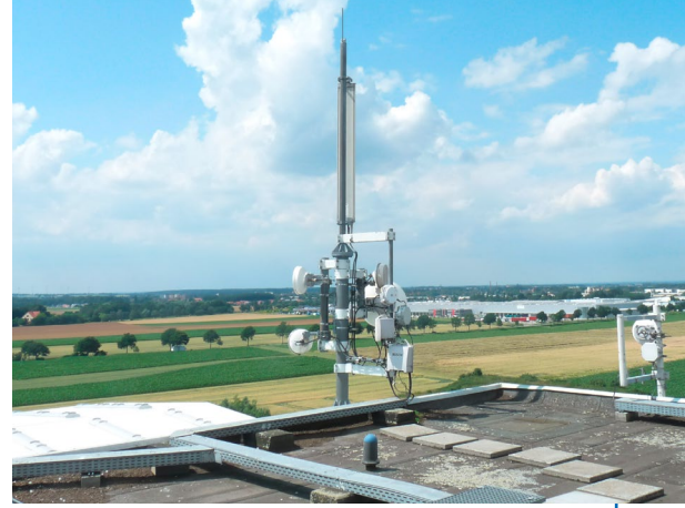
Bild 1: Funkanlage an einem Gebäude mit Flachdach (Quelle: Sven Bonhagen)
