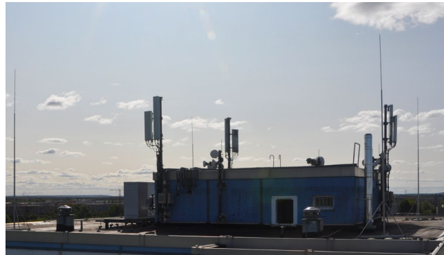
Bild 10: Gebäude mit Gebäudeblitzschutz und getrenntem Blitzschutzsystem für die neu errichtete Funkanlage (Quelle: Telefónica)
