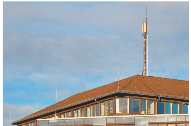
Bild 3: Funkanlage auf Gastgebäude mit Blitzschutzsystem (Quelle: Telefónica)
