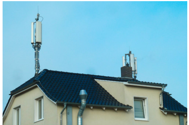
Bild 2: Funkanlage auf Gastgebäude mit Antennenerdung (Quelle: Telefónica)
