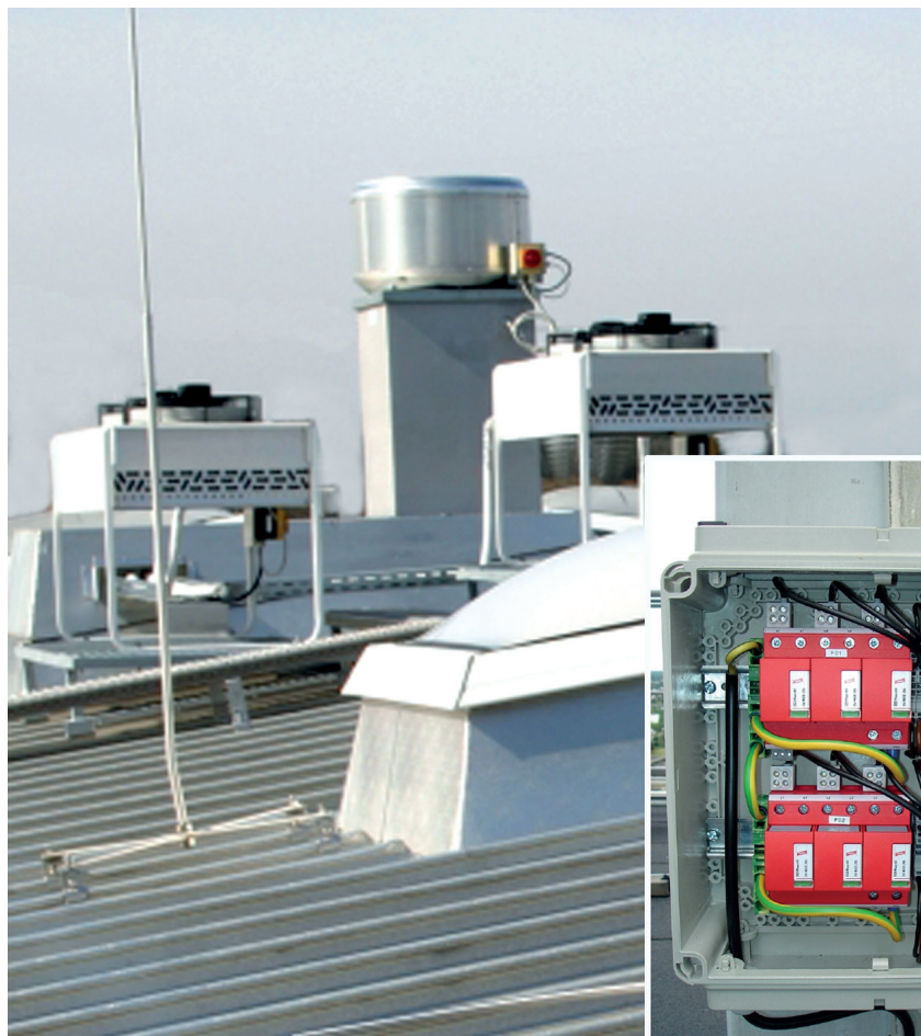
Bild 5. Klimagerät auf der Dachfläche eines hohen Gebäudes geschützt mit SPD Typ 1 entsprechend dem Beiblatt 1 der DIN EN 62305-4 (VDE 0185-305-4)
